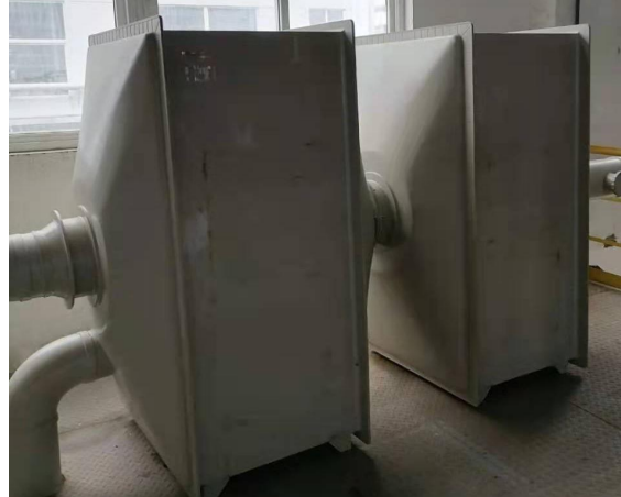
生产车间一二级活性炭装置
