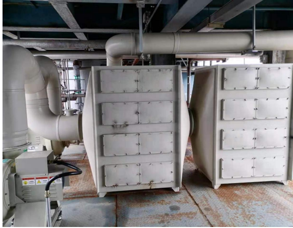
二级活性炭装置（1#排气筒进口端）
