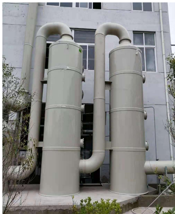
合成车间碱喷淋塔+水喷淋塔
