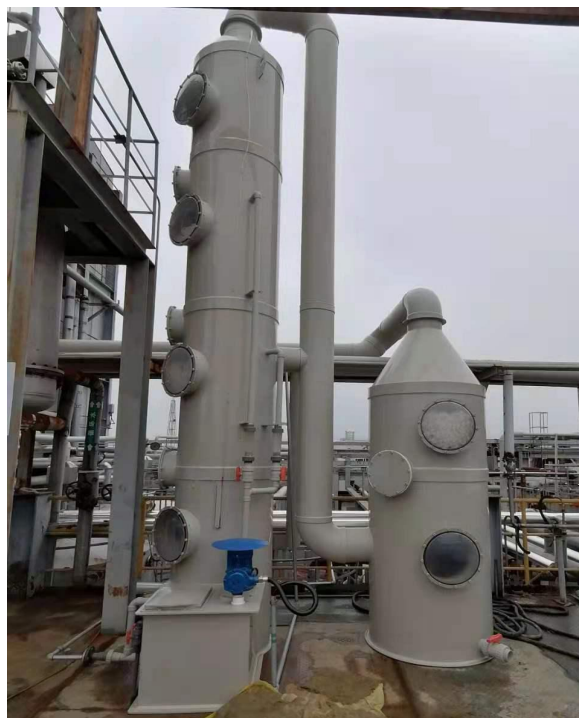
氧化框架碱喷淋塔+除雾器
